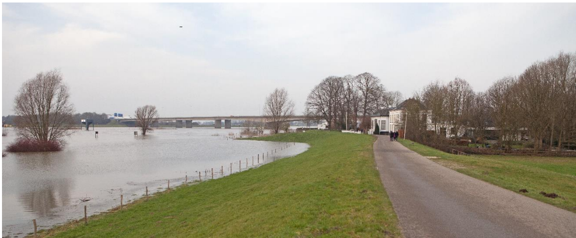
Afbeelding 6.49 Blik op deeltraject 14.2 tijdens hoogwater op de IJssel met woningen dicht op de dijk
