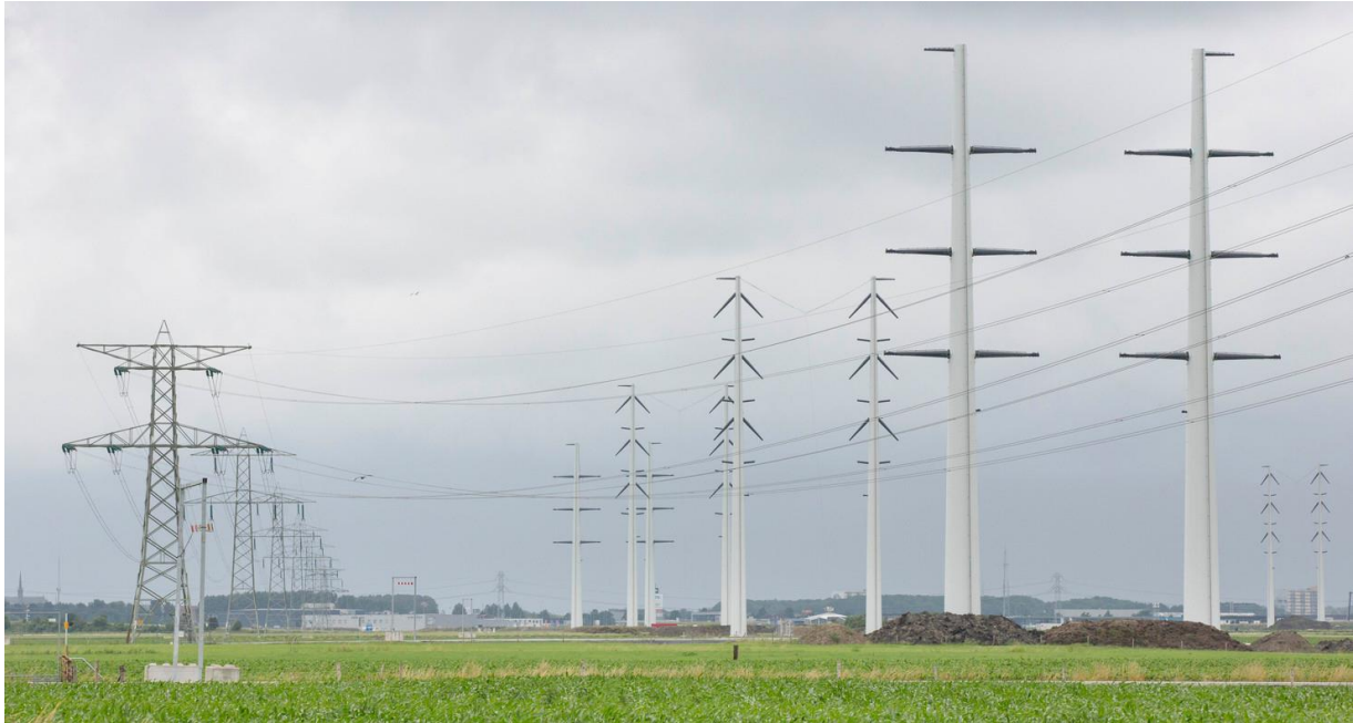
Figuur 3.7 Links een 150 kV 'vakwerkmast' en rechts een 380 kV 'wintrackmast' (bron foto: Johan van der Heijden)
