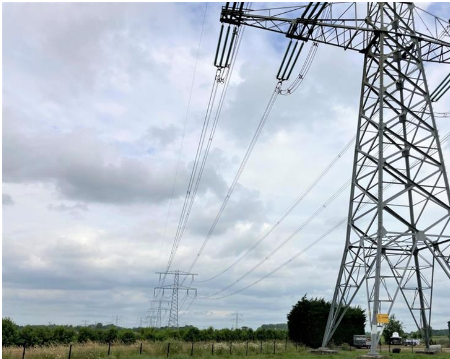
Figuur 2.3 Foto van een 380 kV-hoogspanningsverbinding
