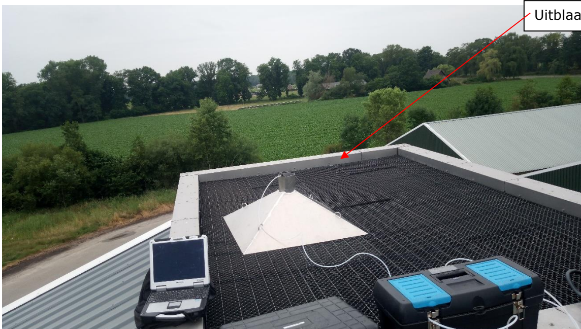
Figuur 2.3 Foto van de meetsituatie van gereinigde afgasstroom Wasser Biggenstal
