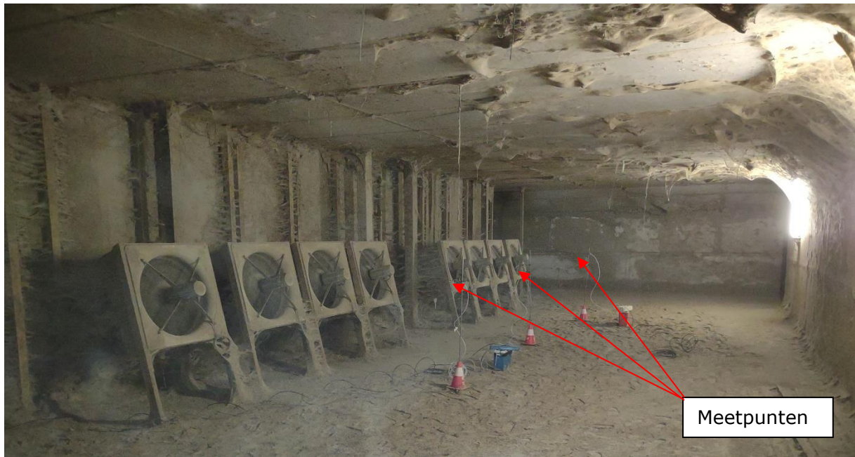
Figuur 2.2 Foto van de meetsituatie van de ongereinigde afgasstroom Wasser Zeugenstal.
