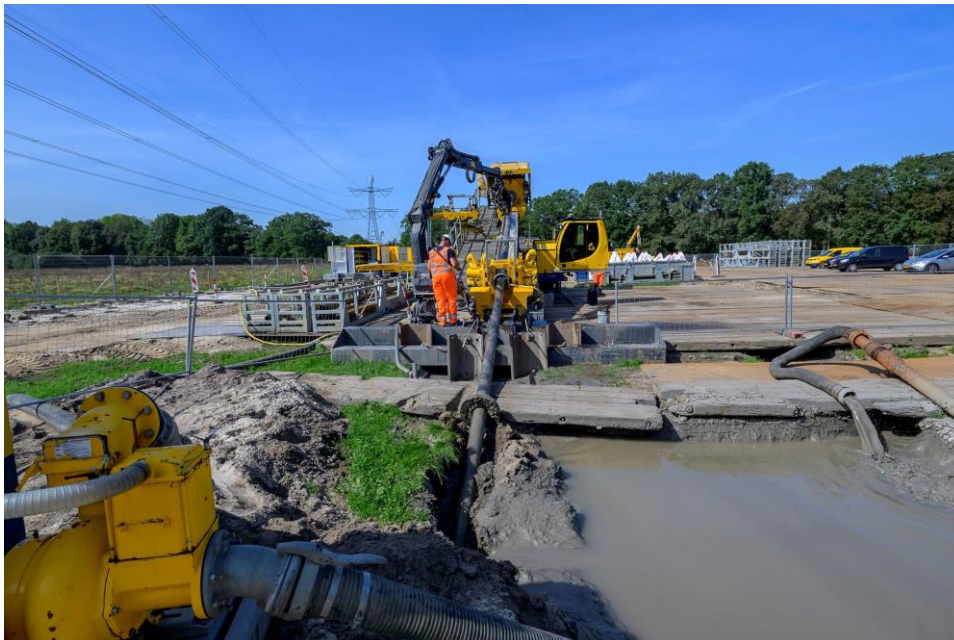
Figuur 2.12 Aanleg van een kabelverbinding door middel van een gestuurde (HDD) boring (bron: TenneT)
