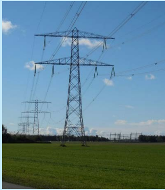
150kV solo steunmast Donau
