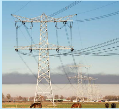
150kV hoekmast Donau
