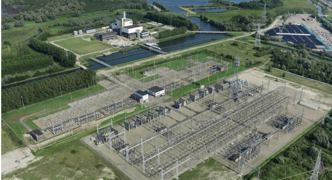
Afbeelding 3.1 380/150 kV-hoogspanningsstation Diemen (Bron: TenneT)
