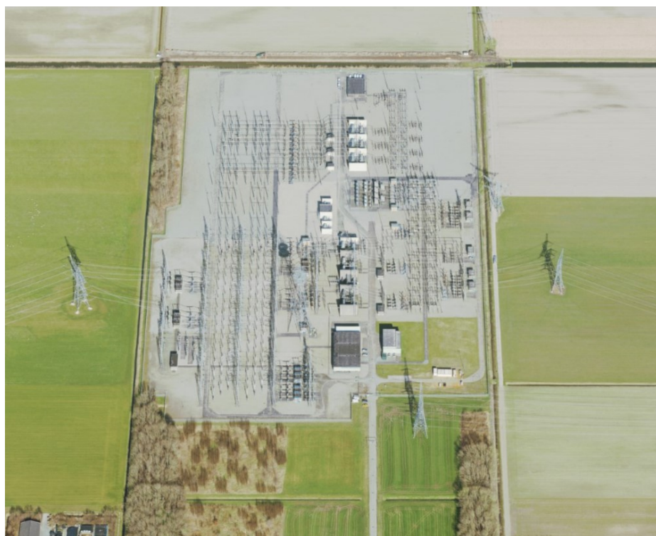
Figuur 5.6 Hoogspanningsstation Ens
